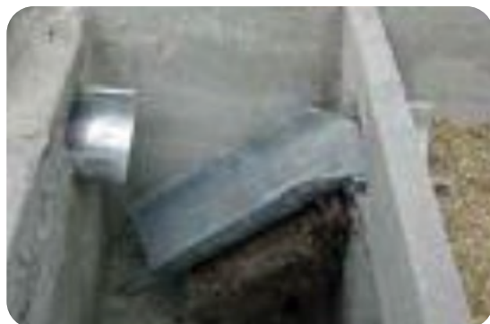
Figure 3 : Disconnecteur avant l'arrivée de la pluie
