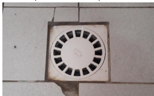
Photo 4 : carreau cassé au niveau du siphon
